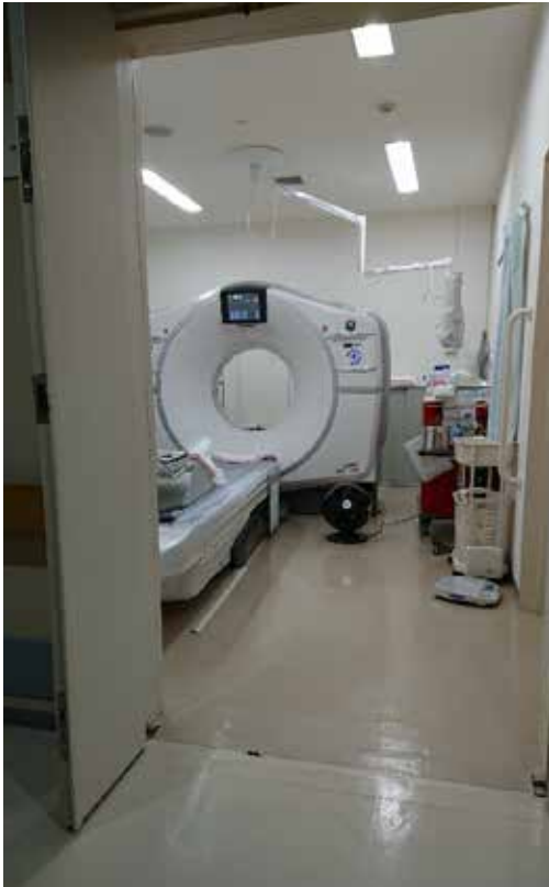
図8 CT検査室の換気状態
