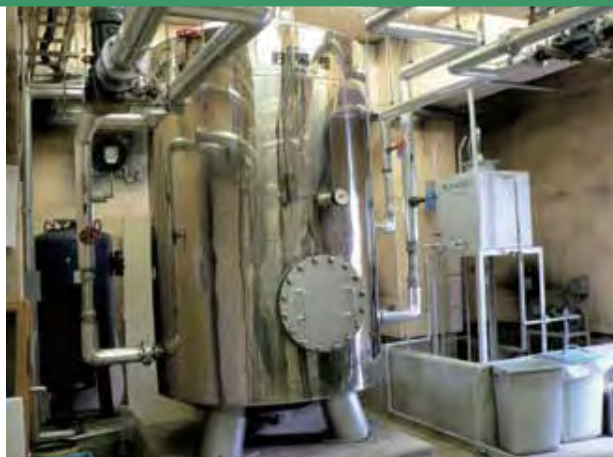
貯湯槽の外観
