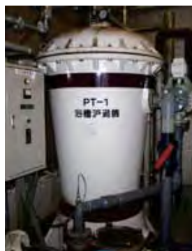
砂式ろ過器の外観例
