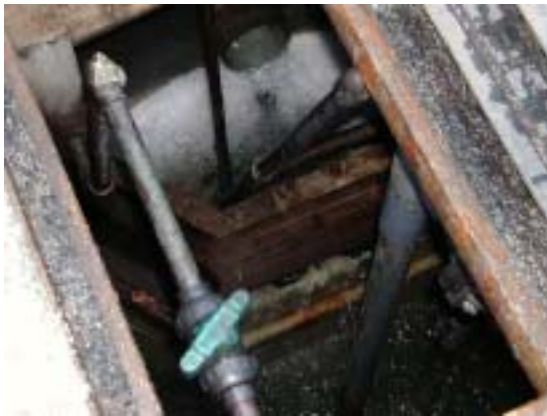
最終沈殿槽 処理がうまくいき、上に見えるパイ プからきれいな水が流れ込んでいる
