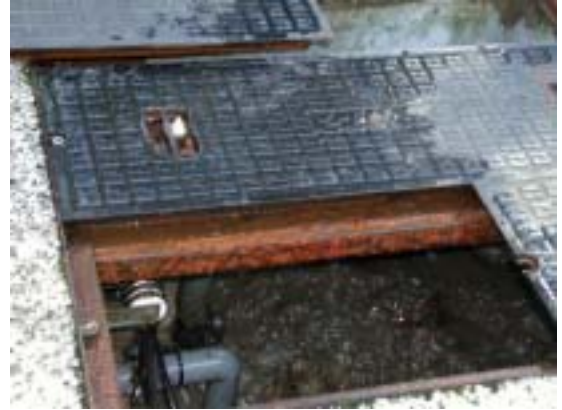
ばっ気槽（活性汚泥処理） エア－を吹き込んでおり、黒茶色の汚泥 があわ立っている
