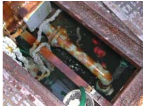
放流槽 塩素消毒後河川へ放流する。手前のゴムホー スが入っているのが滅菌筒。消毒薬（次亜塩 素酸ナトリウム）が白く見える。その横のホ ースが沈んで見える所が放流槽。ここから河 川等に放流される。
