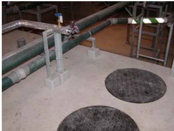
排水槽のマンホール(清掃・点検用) 排水槽は建物内にある場合が多い。
