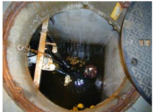
雑排水槽（生活排水を貯留）の内部
