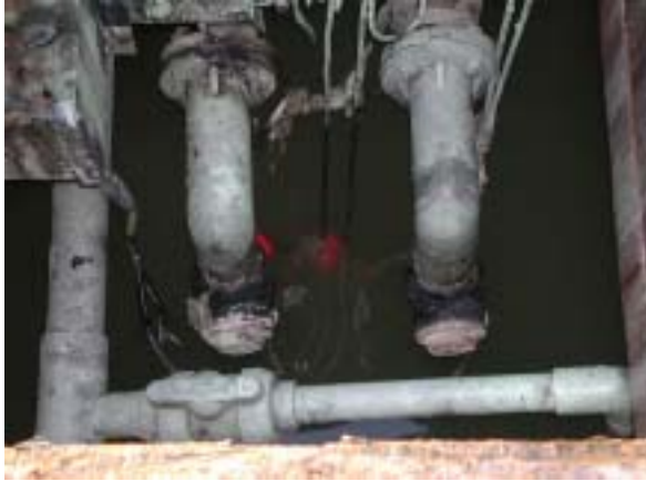
流量調整槽 砂や浮遊物を沈殿させる
