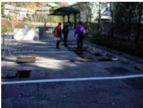
ばっ気槽全景
