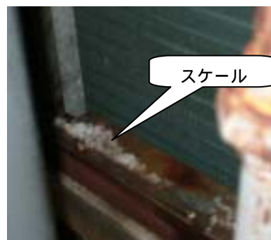
噴霧ノズルに詰まったスケール （固着した蒸発残留物）
