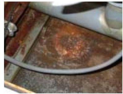
汚れが堆積した排水受け
