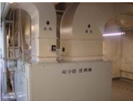
エアハンドリングユニット
