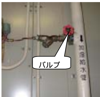
給水配管とバルブ
