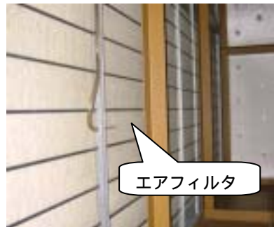
エアフィルタ （エアハンドリングユニット）
