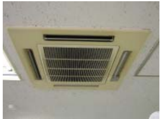
エアコンの吹出口
