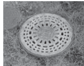
雨水浸透ます
