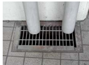
建物の排水ます
